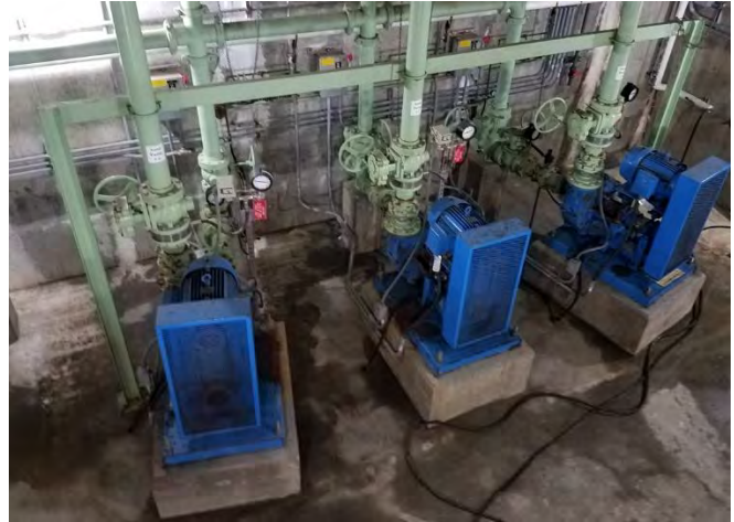
Photo 1: ACTIFLO SAND PUMPS
